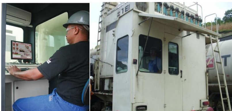
Ilustración 13: Cabina de control de la planta
