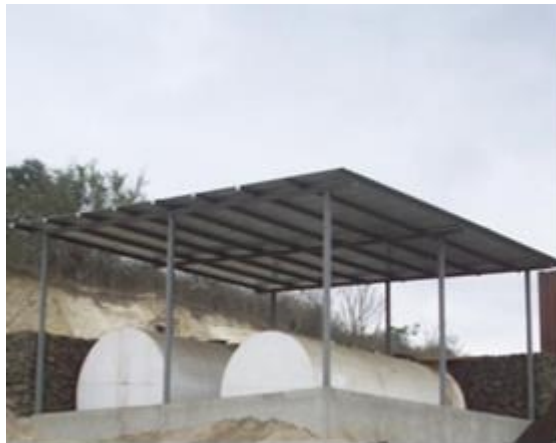
Ilustración 23: Área para combustible
