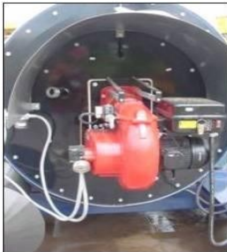
Ilustración 29: Calderas que operan en la Planta "Ciudad
